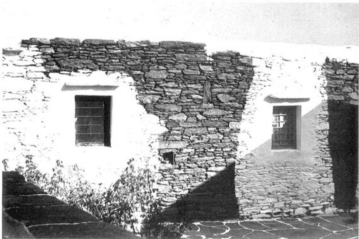
Εικ. 165. Τοίχος με ασβέστωμα μόνο γύρω στα κουφώματα.
