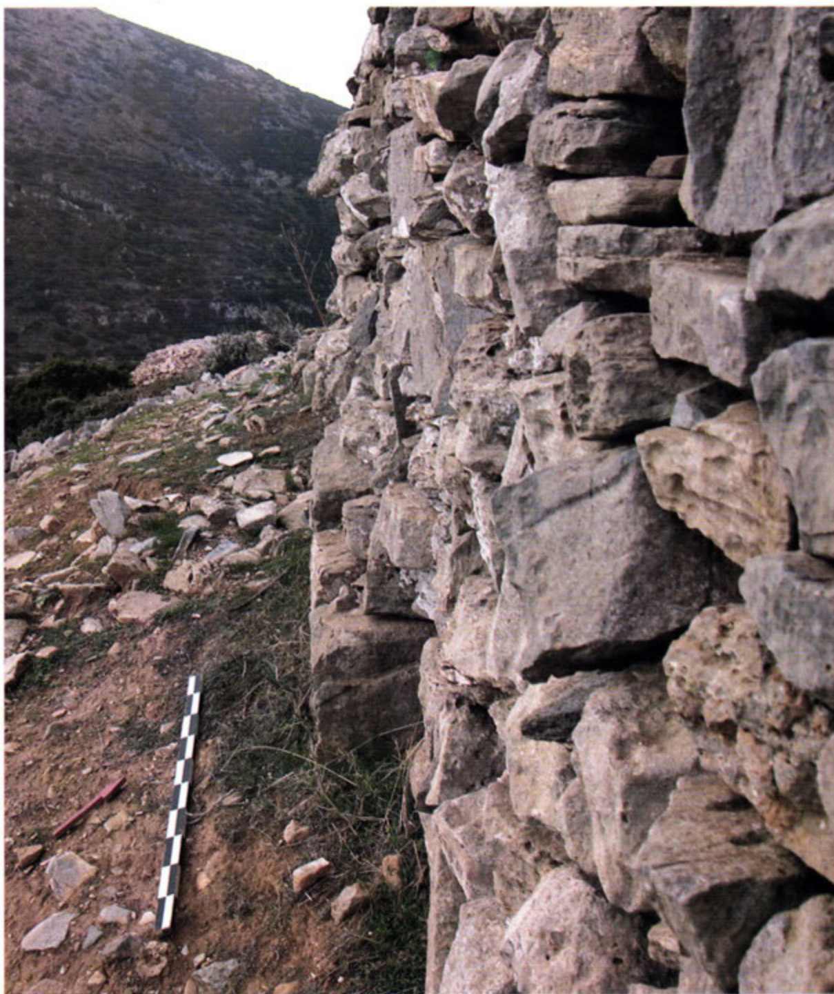
Εικ. 18. Εξωτερικό τείχος, τμήμα της νότιας πλευράς πριν την αφαίρεση του στρώματος καταστροφής.
